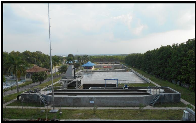
WWTP Kawasan Industri Mitrakarawang
